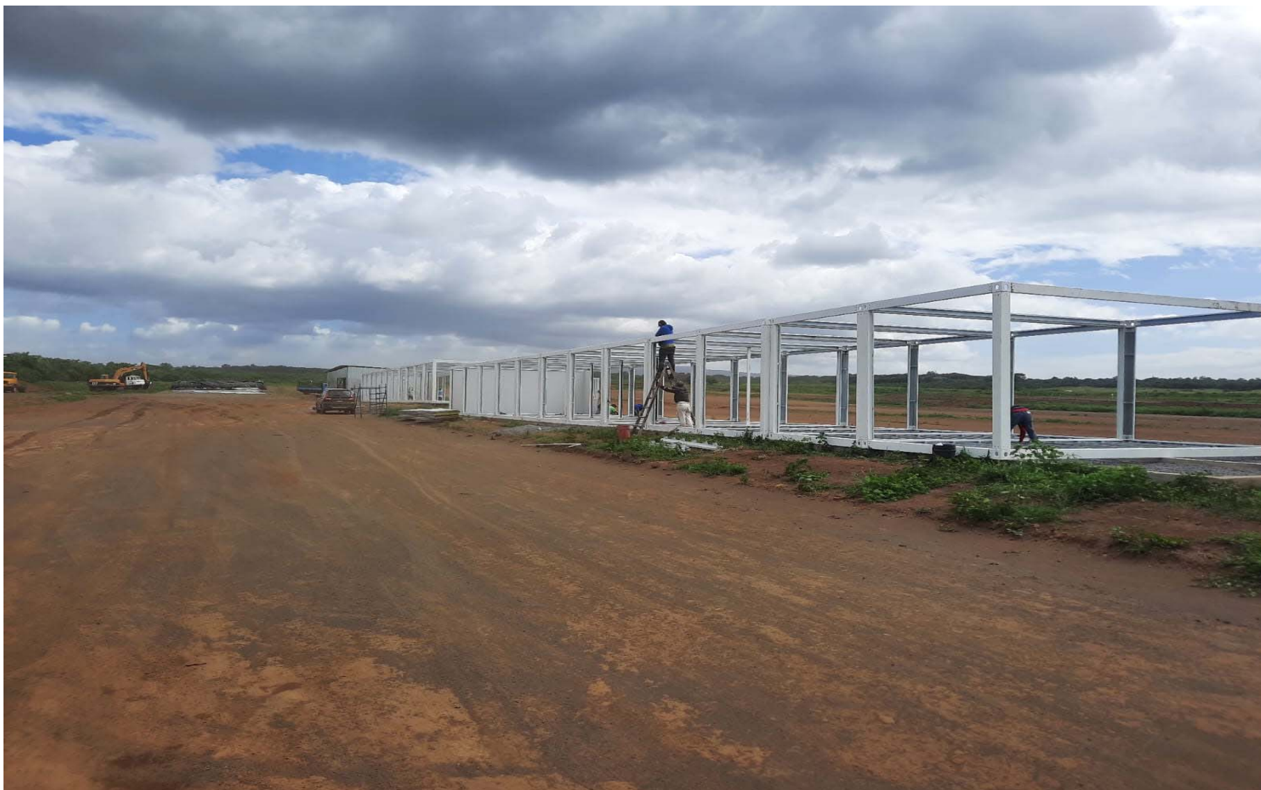
Instalación de campamento provisional de la Empresa China en el sitio de las obras.
